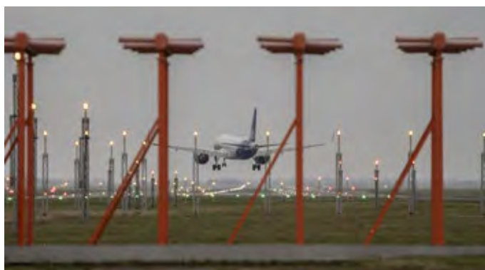
Im Bereich der Airfield Ground Lighting-Systeme sind bereits viele Flughäfen auf LED-Technologie umgestiegen (Bild: Copenhagen Airport).
